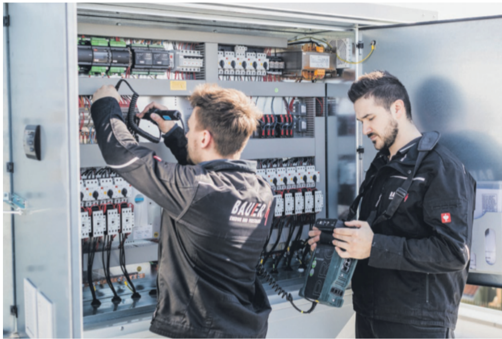
Noch mehr Elektrotechnik-Kompetenz im Landkreis Göppingen: Die Bauer-Gruppe aus Bayern ist nun auch mit einem Standort vertreten, der bereits 80 Mitarbeiter hat – Tendenz steigend.
